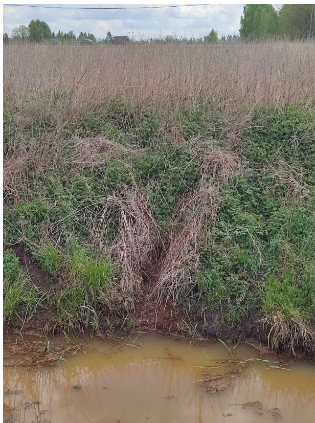
3. Attēls: Esošā drenāžas kolektora izteka pik.12/98. (14.05.2026.)
