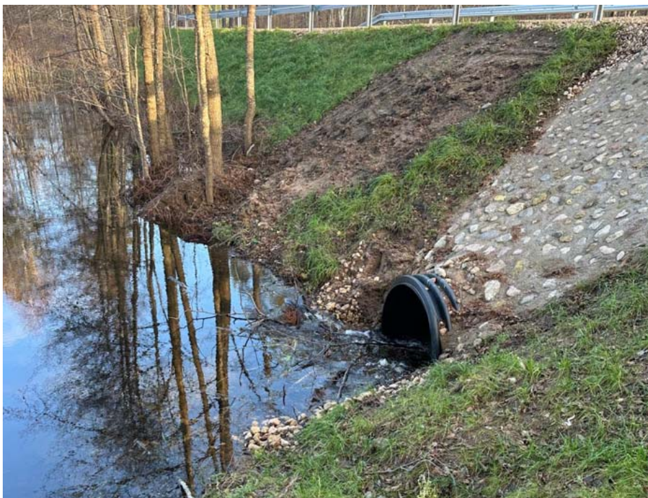
6. attēls. Caurteka zem Vecštāles ceļa.
