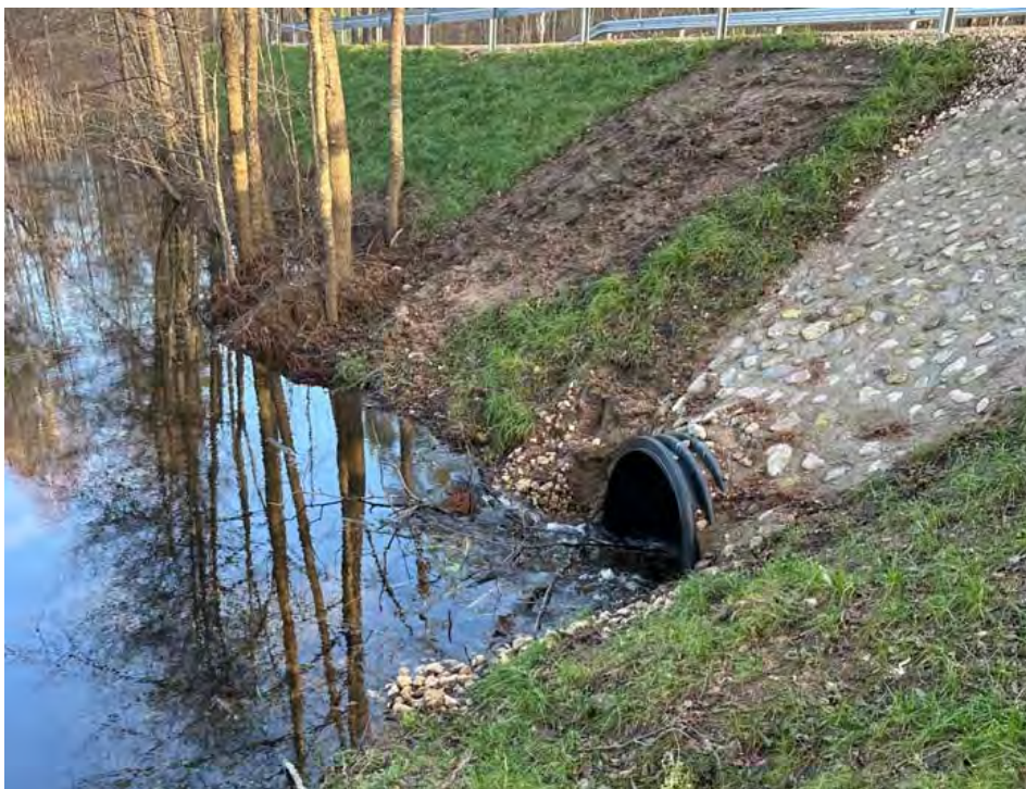
6. attēls. Caurteka zem Vecštāles ceļa.
