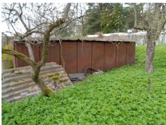
1.1.1-5 Teritorijā mētājās būvgruži un Garāžas konstrukcija atbilst Grausta statusam
