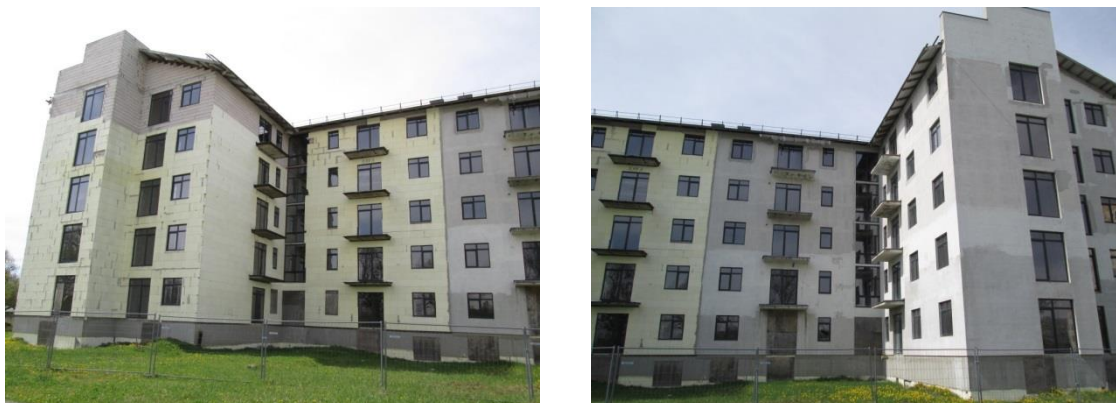
2.20.attēls. Uz daudzdzīvokļu dzīvojamās ēkas uzklātais siltumizolācijas materiāls nav pasargāts no apkārtējās vides negatīvās ietekmes
