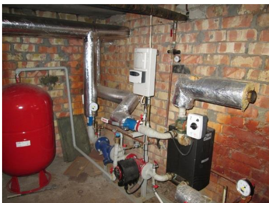
2.12.a attēls. Neatkarīgā pieslēguma tipa siltummezgli ar automātisko vadības sistēmu
